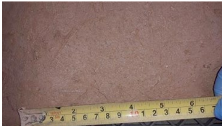
Figura 2. Fisuración en los prototipos.
