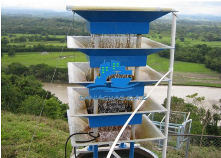
Figura 3. Torre de aireación convencional usada en plantas de tratamiento de agua potable.
