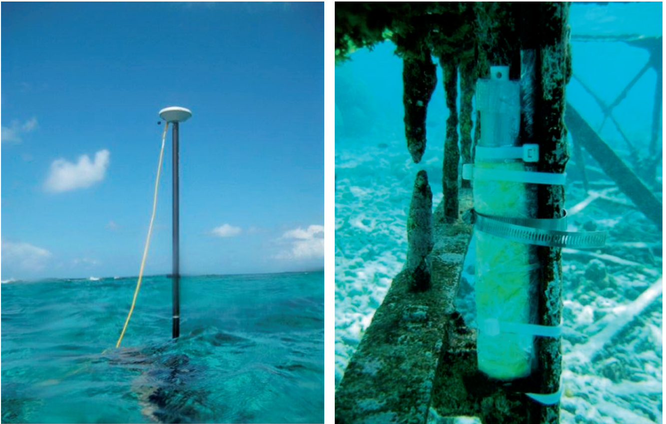
Figura 26. Instalación de mareógrafo en la isla de Quitasueño. (Foto: Dimar-CIOH).
